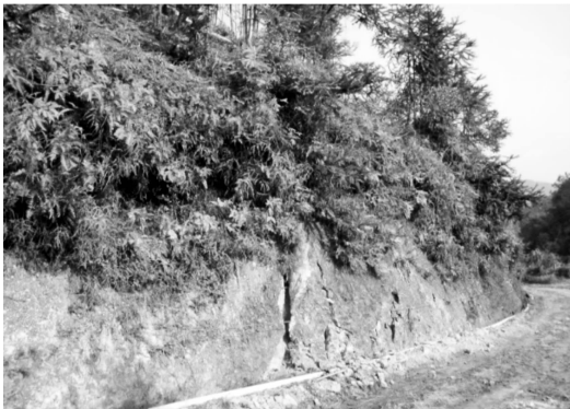
图 5 边坡失稳现场 Fig. 5 Slope instability of the scen
